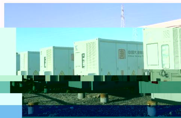
大唐鲁北储能项目 100MW/200MWh
